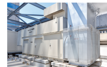
非常用発電機(屋上)
